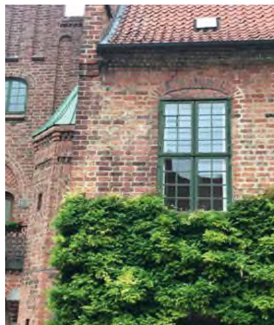
Figur 25. Dette vindue i Priorindefløjens sydfacade ses tilmuret på Nyrops tegninger fra 1889. Til venstre for vinduet er murværket udbedret med nyere, mørkere sten halvt skjult under beplantningen, hvor der tidligere har været en tilmuret indgangsdør. Det er muligvis sket samtidig med retablering af vinduet eller ved sammenbygning med den nye beboelsesfløj. Foto: Søren Lyder Jacobsen/Roskilde Kloster.
