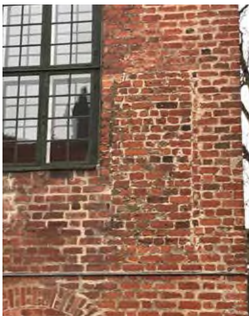
Figur 24. Kirkefløjens nordfacade med tydelige spor af en tilmuring, som indikerer, at der her kan have været en indgang fra et senmiddelalderligt trappetårn. Foto: Søren Lyder Jacobsen/Roskilde Kloster.
