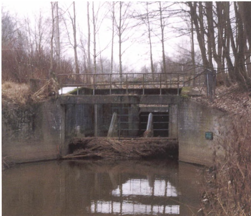
Fig. 5. Bromølle-tunnelen, indgangen til den endelige løsning på besværet med de ustabile jordbundsforhold ved Bromølle. Her fra løber Åmose Å næsten én km i en lukket betontunnel. Jordskred vil ikke længere kunne stoppe vandets frie flugt. Anlægget blev bygget ved reguleringen 1957-64. Foto J.Chr. Mohr.
