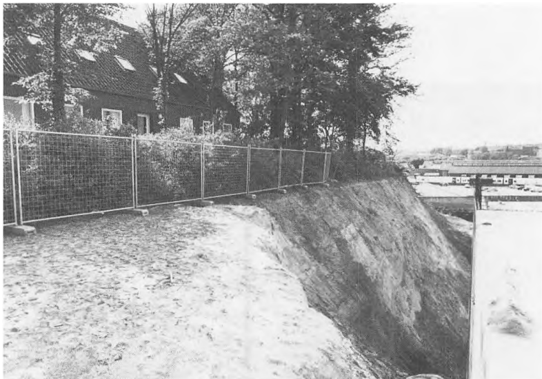
»Børnely«, nabo til det kommende kongres- og hotelcenter nær Musikhuset, bliver evakueret af frygt for sammenstyrtning onsdag den 12. juni, da man bliver opmærksom på, at der er skyllet en stor mængde sand væk fra en skrænt mellem byggeriet og børneinstitutionen. (Foto: Dan Jakobsen).
