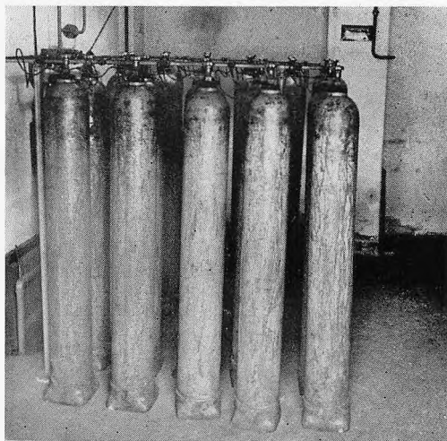
Gaskompressor-Anlæg med tilhørende Gasflasker.
