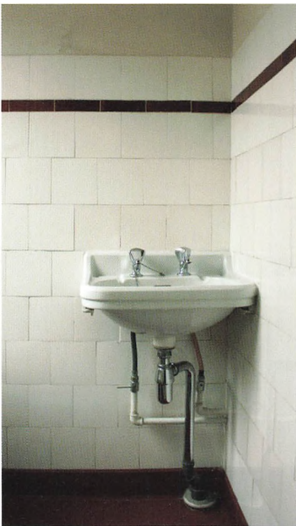
Et gæstetoilet, hvor de fine, gamle fliser, opsat forskudt for hinanden med knasfuge (helt tæt), er bevaret.
