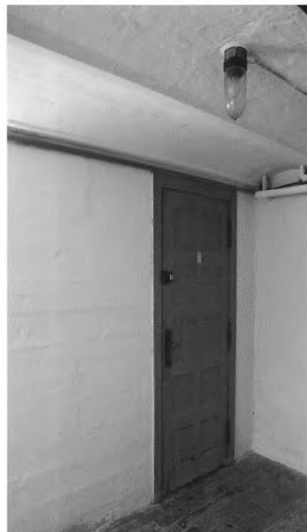
Enkelte steder har man i kældre anvendt såkaldte »monier-hvælv«, flade, murede hvælv, der er opmuret mellem jernbjælker og efterfølgende kalket. Disse hvælv var i øvrigt helt almindelige i landbrugets driftsbygninger.
