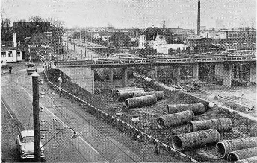
I 1958-59 blev der anlagt to jernbaneviadukter over Buddingevej til afløsning af de gamle bomme. På dette foto fra april 1959 kan man iagttage arbejdet. Bommene levede deres sidste dage i eksil foran den gamle Buddinge Kro! (Det kgl. Bibliotek).
