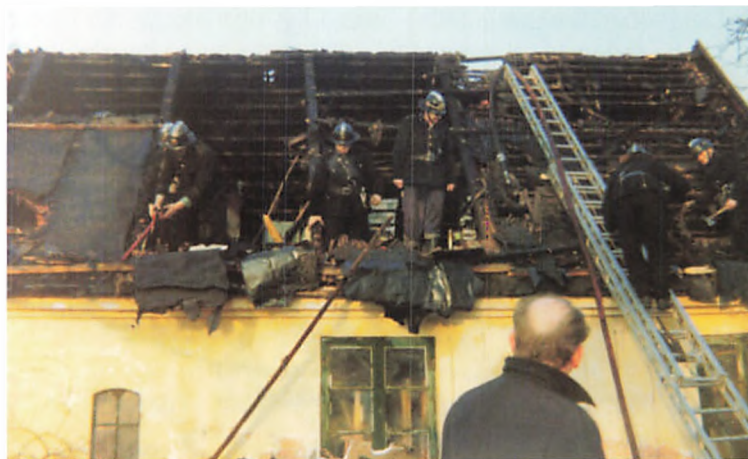
Det lykkedes at begrænse en brand i købmand P. Jensens udhus i Tikøb. Branden brød ud den 30.12.1968. Brandfolkene er her i gang med at sikre sig at ilden ikke ulmer i revner og sprækker - derfor fjernes tag og tagkonstruktion m.v. (Foto: Leif Petersen)
