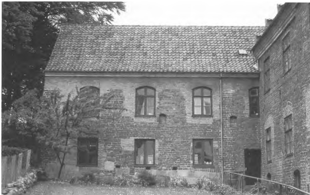
Senniddelalderlig økonomi- og udløberfløj i Viborg Gråbrødre Kloster (G og J på side 106). Bygningen til venstre var opført med to lave etager, hvoraf den øverste var forsynet en række små fladbuede lysåbninger. Foto: Erik Levin Nielsen.
