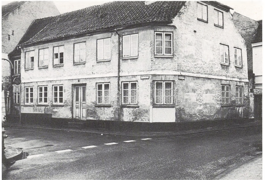
Kapellanstræde 7. Foto 1973. Fotografiet er taget i december 1973, og viser hvor alvorligt det står til med denne bygning. Det er yderst påkrævet, at en omfattende restaurering hurtigst muligt igangsættes.
