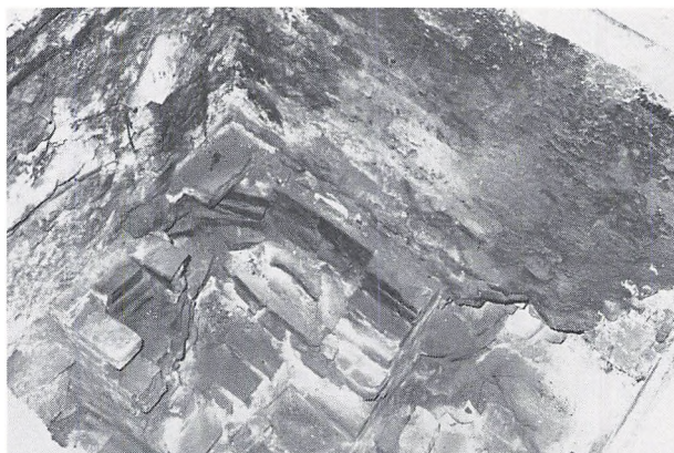
Fig. 10. Delvist nedbrudt ildstedsbænk i skorstensrummet på ejendommen Fabersvej 10. Foto: Julius Jørgensen.
