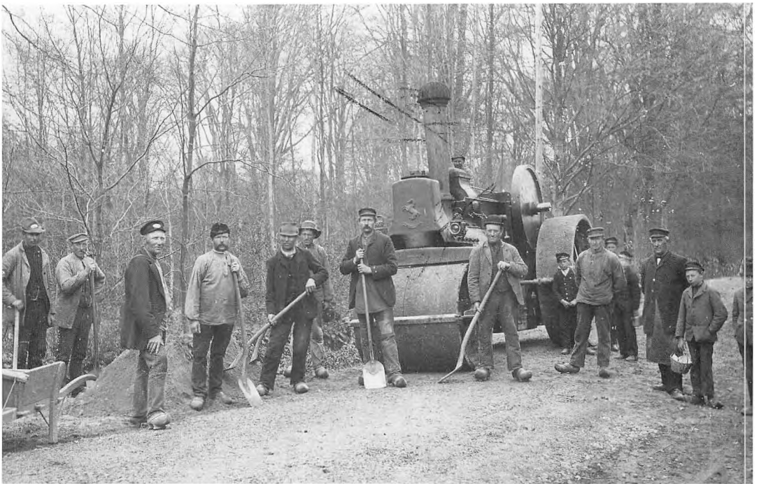
Vejarbejde på "Lundebakken". Nr.4 fra højre er vognmand Rasmus Petersen. Foto fra 1920'erne.
