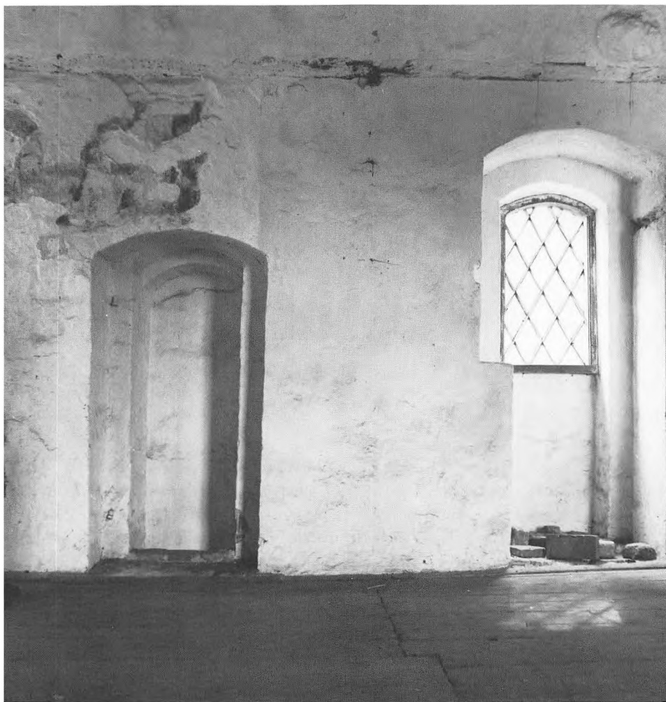
Dør til hemmelighed og oprindeligt vindue (som senere er ændret til en dør) i boligetagen.
