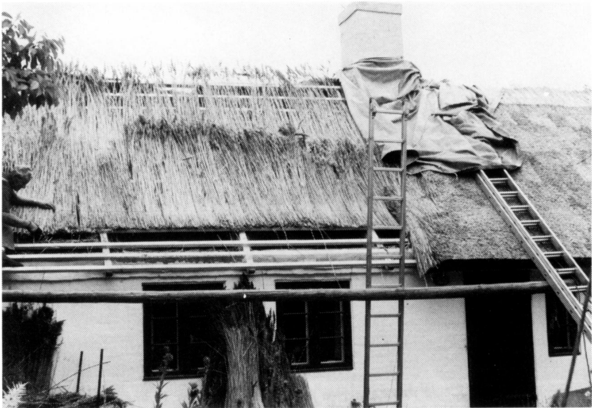
Juni 1997, Wolthersvej 8: Brolaget, et tyndt lag rør, der skal skjule topkvasterne på tagets inderside, er syet på. Tækkemand Jørgen Kristiansen, Meløse. Foto: Ole Høegh Post.
