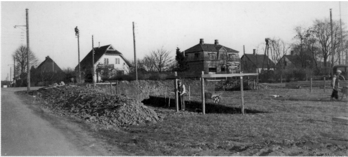
Grunden til den nye Landbobank-bygning på hjørnet af Kollerødvej og Frederiksborgvej håndgraves i 1935. Bagved ses den tidligere bankbygning.
