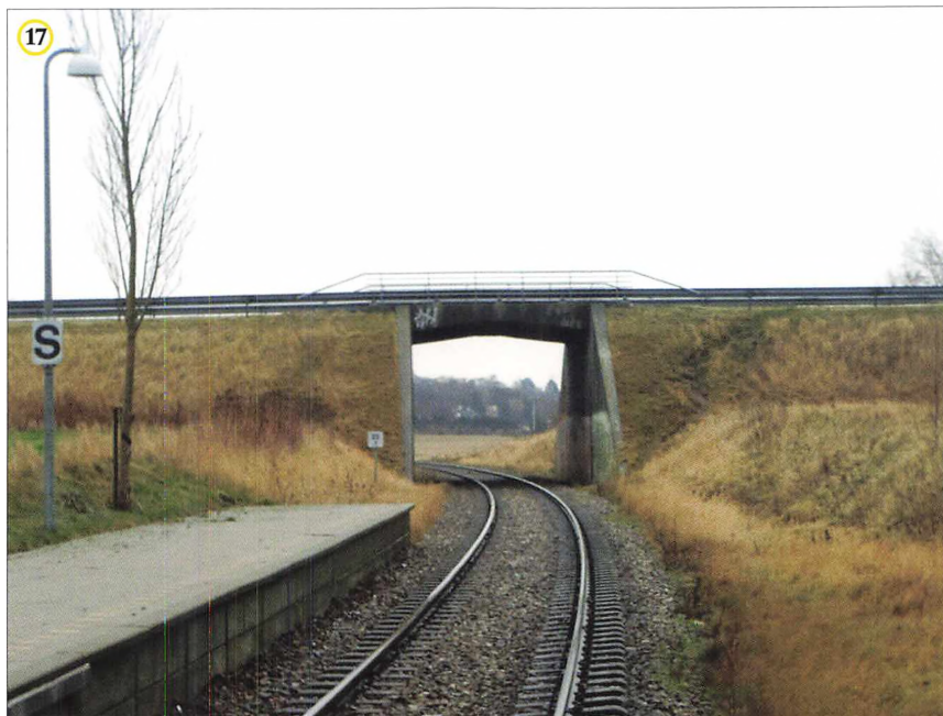
Viadukten af Kildevejen ved Hollose Trinbræt, et gudsforldt udtryk fra 1970-erne. Foto: Lars Windfeld-Hoeberg
