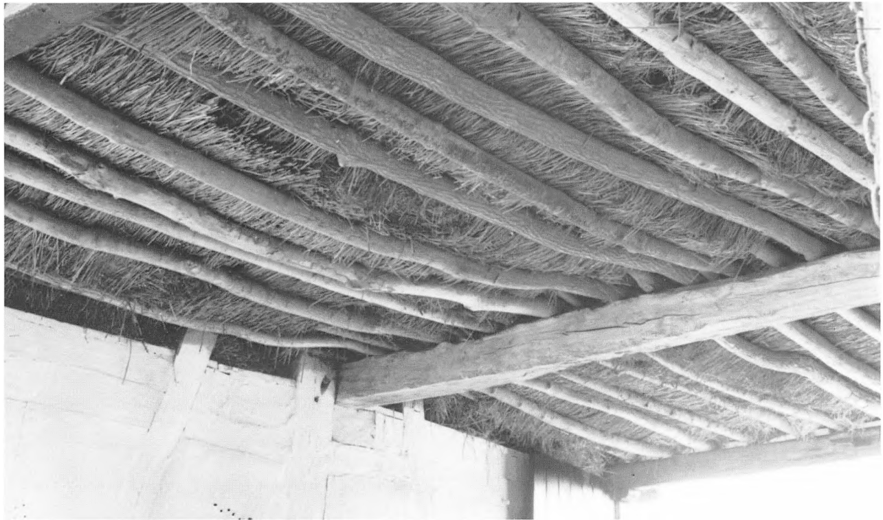
Fig. 57. Slyde i port i sydlængen på en gård i Strærup på Sydvestfyn. Andre steder ofte betegnet som et stænge, idet der i stedet for loft er lagt stænger eller rafter på tværs, dækket af et lag halm. Det bemærkes, at også denne gård er en sulegård, idet sulen midt i tværvæggen som sædvanlig omslutes af to skråstivere.
