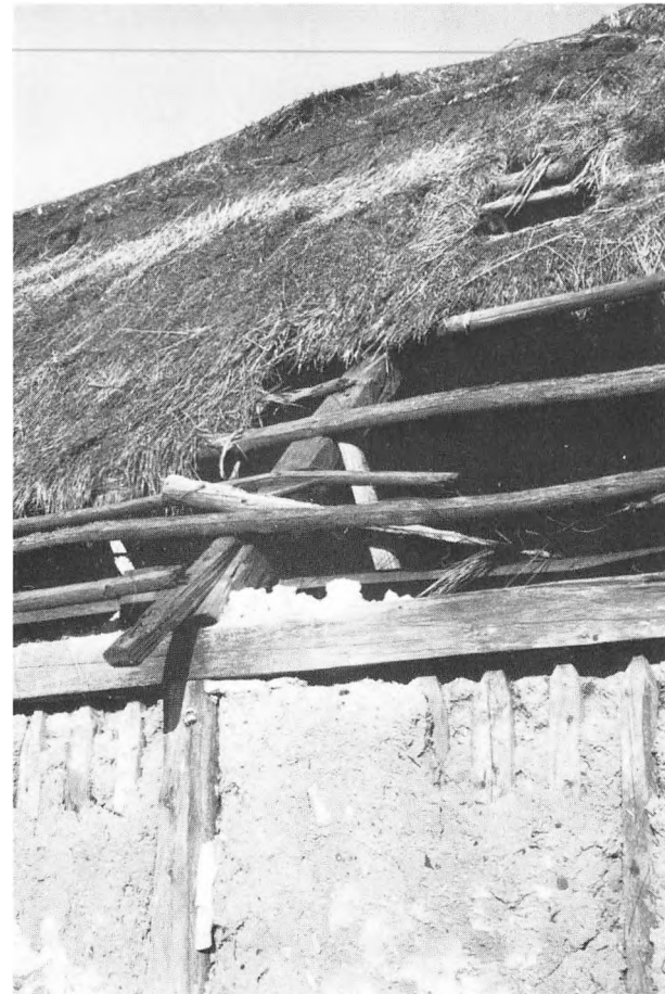
Fig. 13. Her ses skalken, der er sømmet på spærfoden. Herved føres tagskægget så langt ud fra væggen, at lerkliningens beskyttes mod udvaskning. Under det ødelagte stråtag ses, at de tværgående lægter er sømmet på spærene, der står på tagremmen. I den ødelagte lerklining ses enderne af de tilspidsede, lodrette støjler. De er anbragt i huller i tagremmens underside. Gård i Svogerslev.
