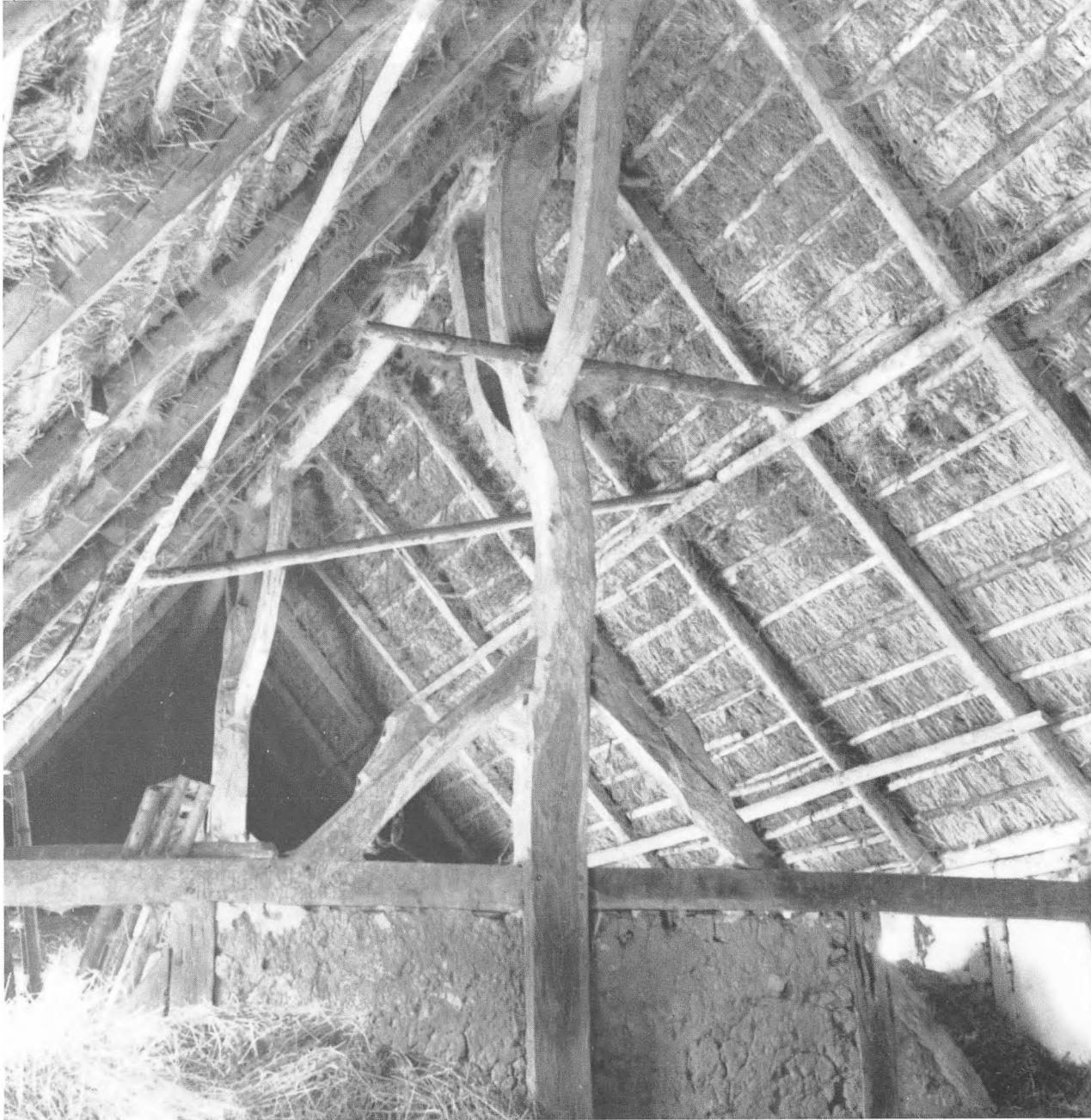
Fig. 54. Sulebygget lade i Dærup øst for Assens. Her ser man, hvorledes højsulerne bærer rygåsen og er støttet af skråbånd både i længde- og tværretningen. Tagkonstruktionen består af hængeltræer med lægter over.
