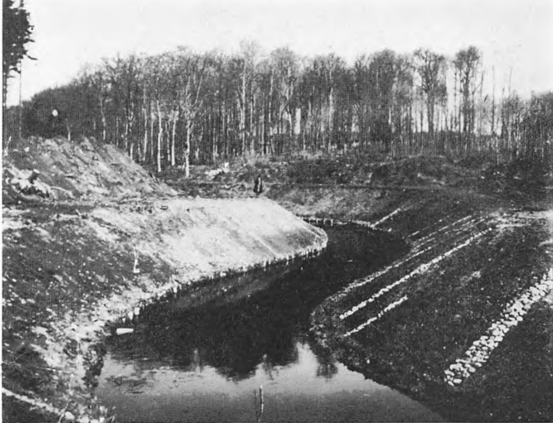
Halleby å neden for Bromølle i Holbæk amt. Arbejdet med åens uddybning blev afsluttet i 1932. Man bemærker de store sikringer af åens sider.
