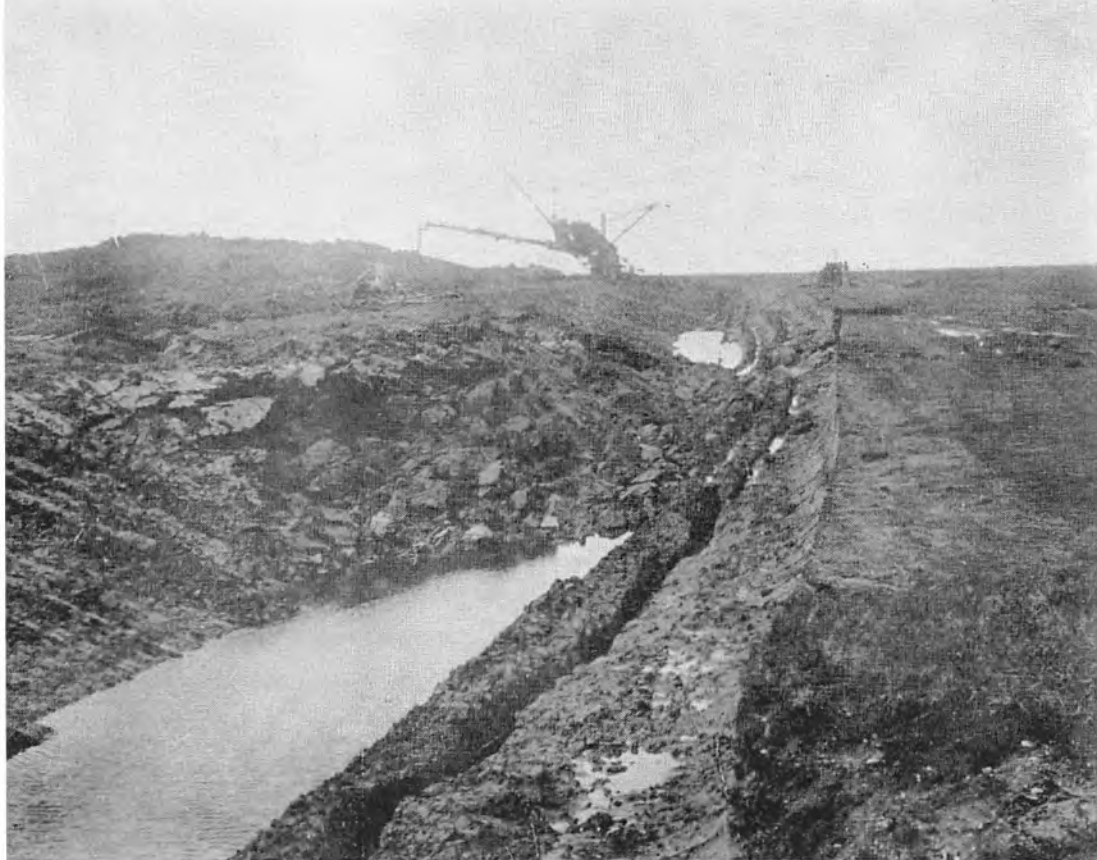
Darum-Tjæreborg havdige. Skred i diget 14/8 1927.
