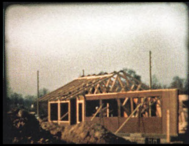
Den 18. april 1967: Så er det tid til at bygge selve huset. Her ses såvel væg- som tagkonstruktionen.
