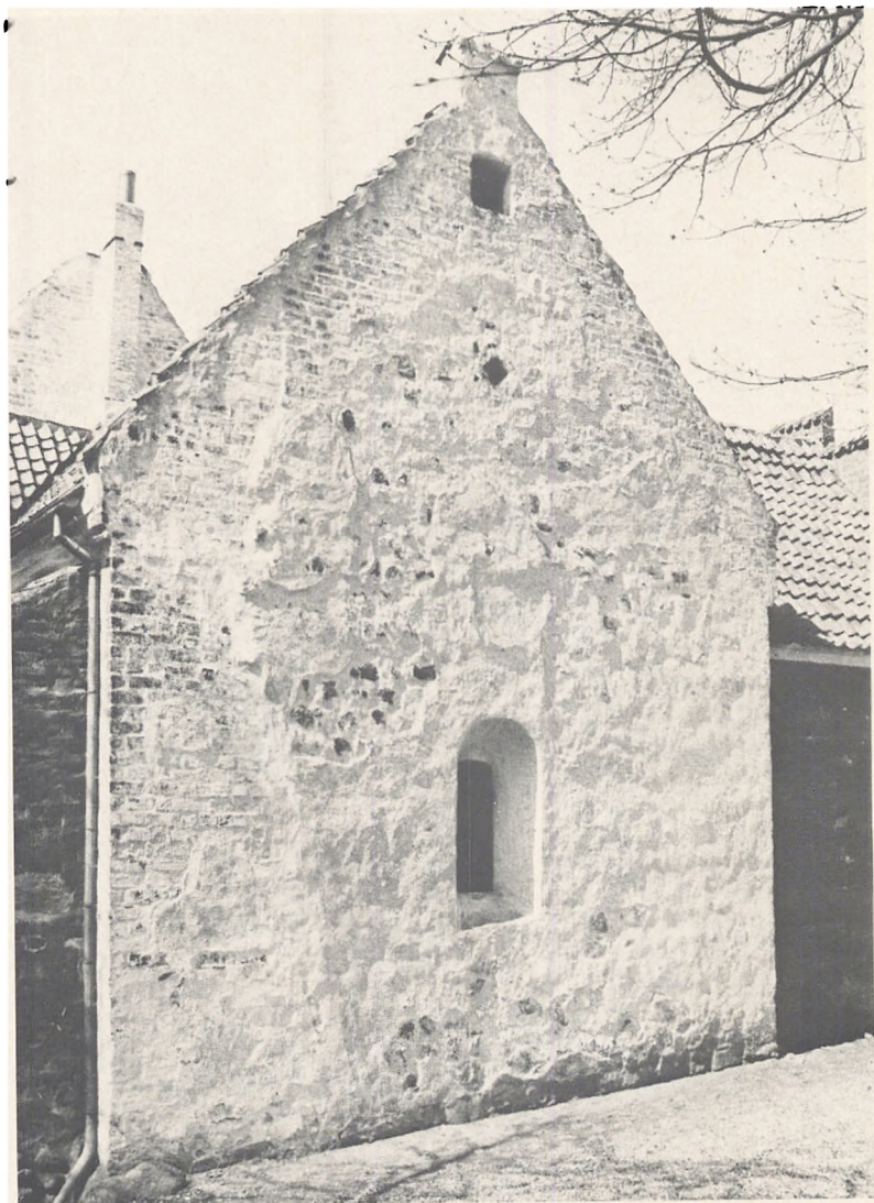
Fig. 12. Korets østgavl. Funderingsproblemer ved sydøsthjørnet har gjort flere forskellige ombygninger nødvendige.
