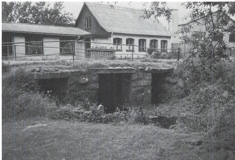
Fig. 3. Bro over Kalv'åen ved Tingtved-Borup. Opførelsesåret ukendt. I type slutter den sig klart til de broer, som opførtes omkring midten af 1800-tallet på de mindre landeveje og biveje i Holbæk amt. K.-E.H. fot. 1984.
