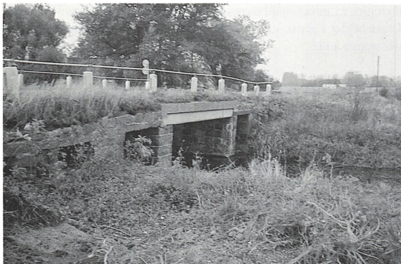
Fig. 6. Broen over Svinninge Vejle, opført 1828-1829. Oprindelig med 8 gennemløb. I 1907 blev broen udvidet og de to midterste gennemløb slået sammen, og broen fik betondække. I 1977 var broen atter genstand for en udvidelse. Man må i dag konstatere, at den valgte fremgangsmåde med at flytte pillernes facader ud og lade udvidelsen ske bag disse, ikke har givet et æstetisk vellykket resultat. K.-E.H. fot. 1977.
